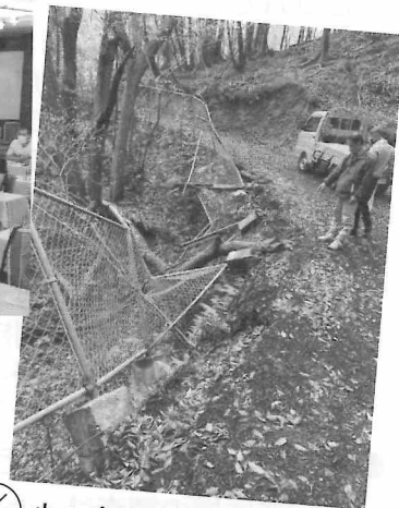
③/②⑨ 小ヶ倉地区道路崩壊箇所調査
